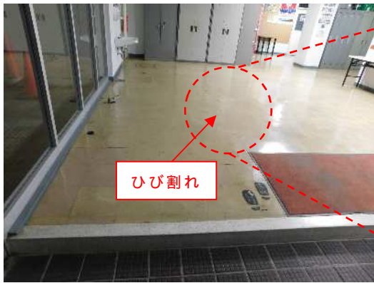
写-2.2.1 床(ひび割れ)【D判定】 (中央コミュニティセンター)
