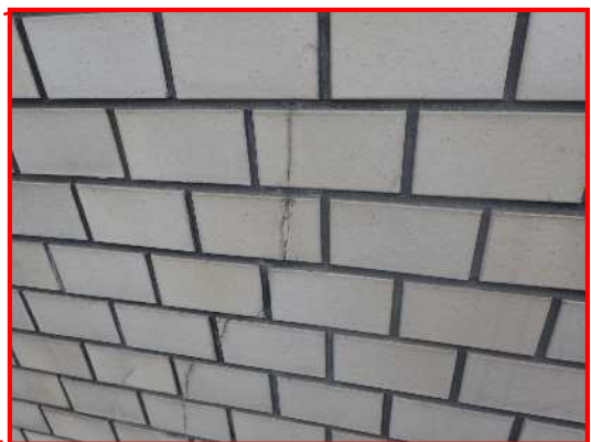
写-2.2.6 タイル(ひび割れ)拡大写真 (農村環境改善センター)
