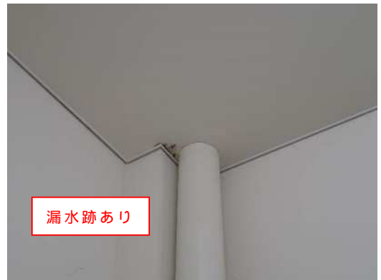
写-2.2.4 天井(漏水跡)【C判定】 (駅東地域交流センター)
