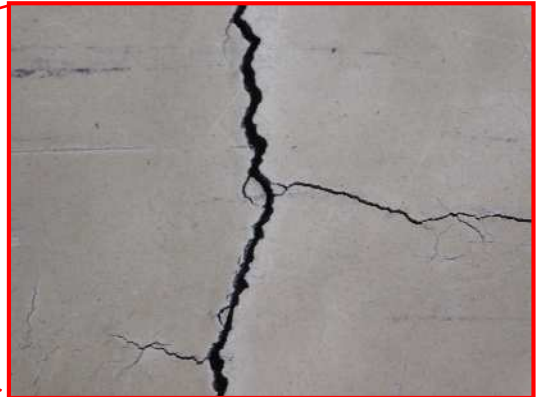
写-2.2.2 床(ひび割れ)拡大写真 (中央コミュニティセンター)
