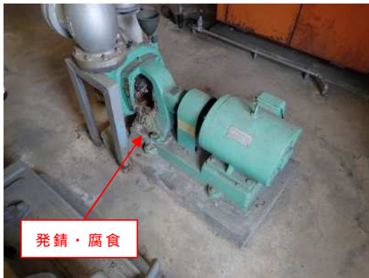
写-2.2.3 ポンプ(発錆・腐食)【D判定】 (中央コミュニティセンター)
